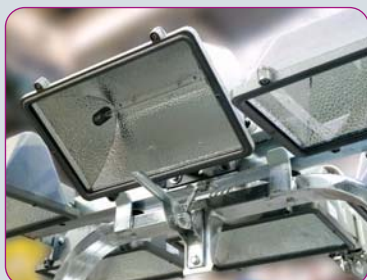
Base de apoyo de los focos
