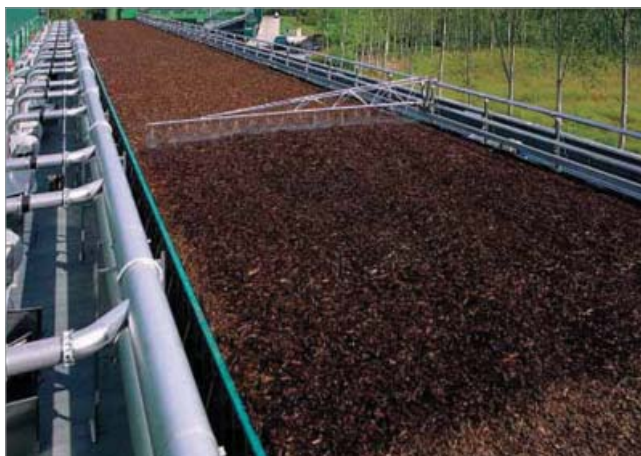
Planta de biofiltración
