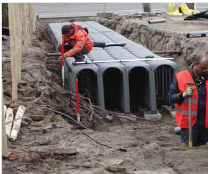
Cámara con función protectora de raíces
