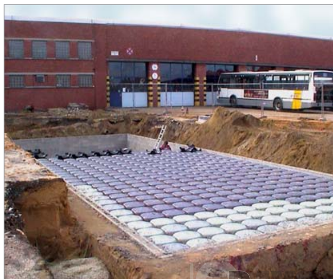
Cisterna de recogida debajo de un aparcamiento
