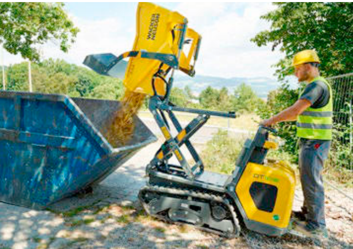
Caja de volteo en altura
