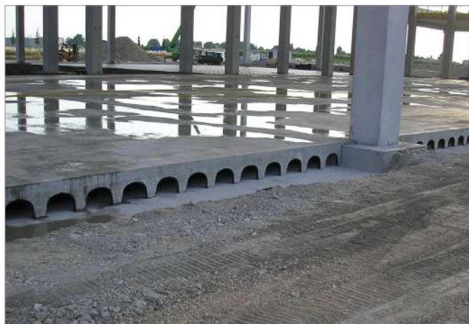
Espacio ventilado para cámaras frigoríficas
