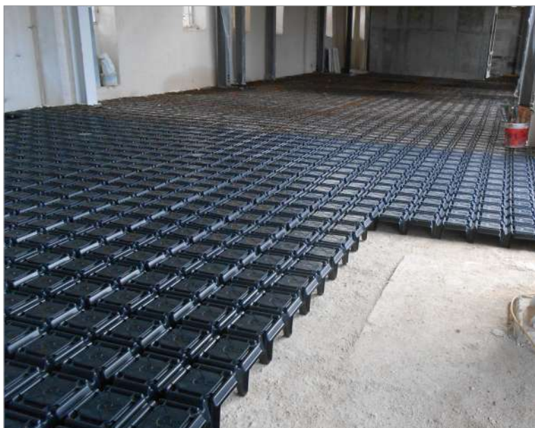
Cisterna de dispersión debajo de un aparcamiento comercial
