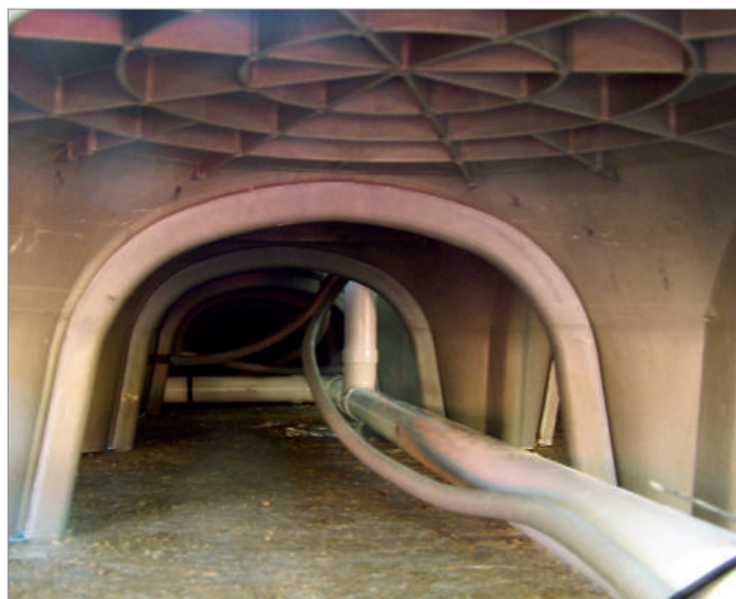
Ejemplo de paso de instalaciones
