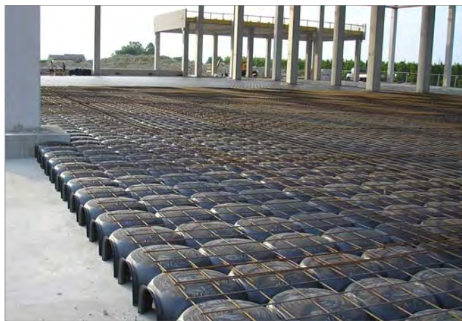
Hueco ventilado para cámara frigorífica
