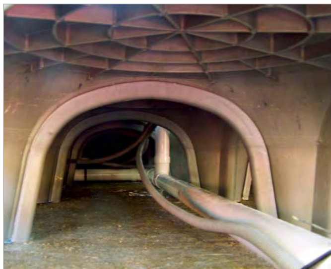
Ejemplo de paso de instalaciones
