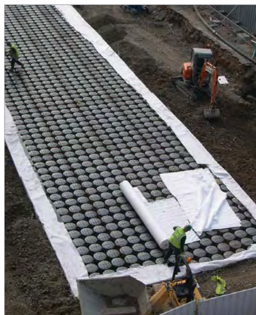
Cisterna de recogida de agua
